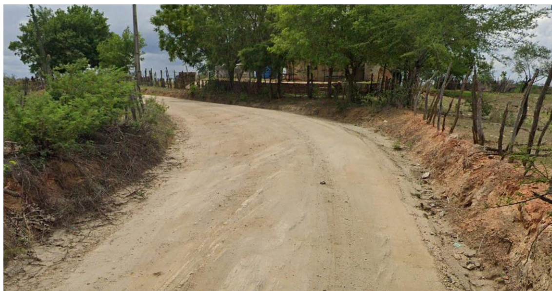
FOTO 12 - EST. 178 – VISTA SENTIDO DECRESCENTE DO ESTAQUEAMENTO (EM DETALHE OMBREIRA PASSAGEM MOLHADA DE PASSAGEM – RECUPERAÇÃO DO PISO DE CONCRETO)
